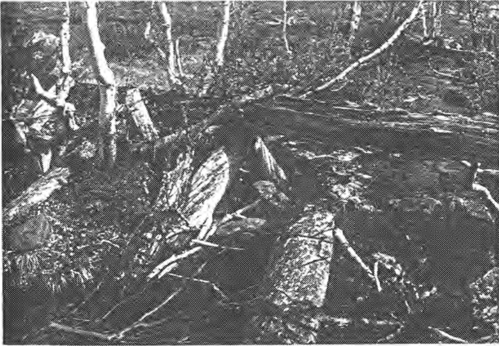
Rester av dambru, sett fra nord
