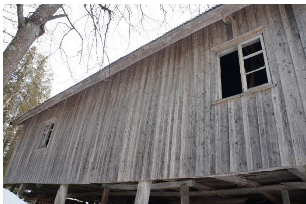
Nordfasade. Flere av vinduene mangler glass og sprosser, noen mangler også hele rammer. Foto: Dag Lindbråten, 2017
