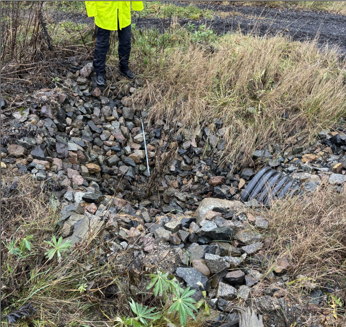
Figur 4.9: Utløp fra eksisterende stikkrenne 4. På utløpssiden er det kun en steinsatt grop uten noe definert avrenningsvei. NIRAS Norge AS.
