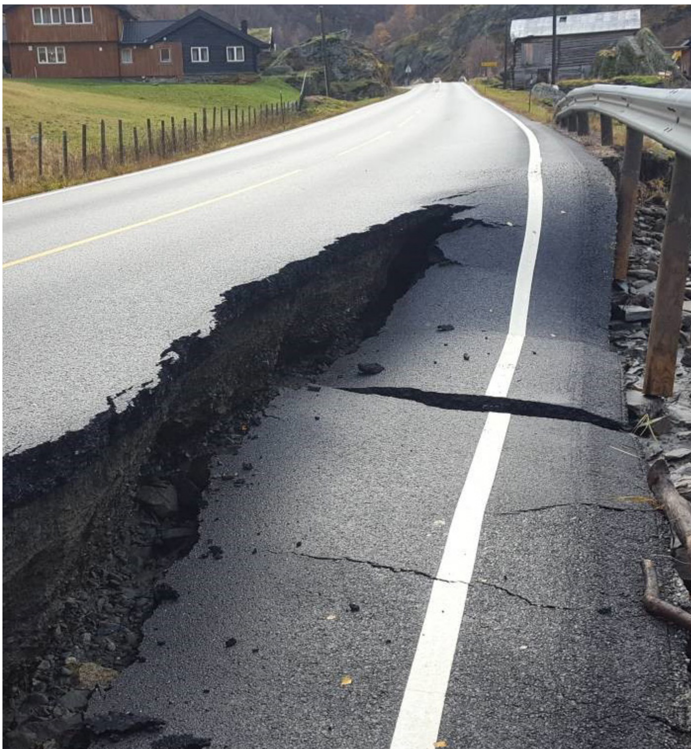
Flomskader på fv.55, Lom. Foto: Statens vegvesen
