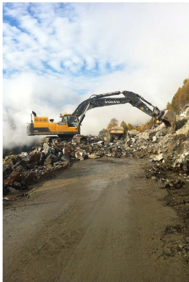
Utbedring av flomskader. Foto: Sissel B. Ingvaldsen
