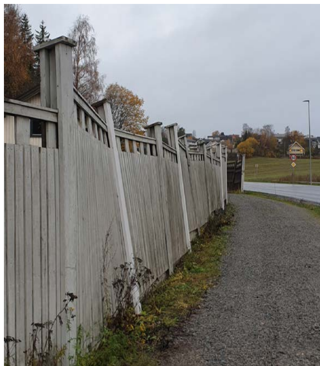
Støyskjem som må skiftes ut, fv.224. Foto: Kine Skarstein
