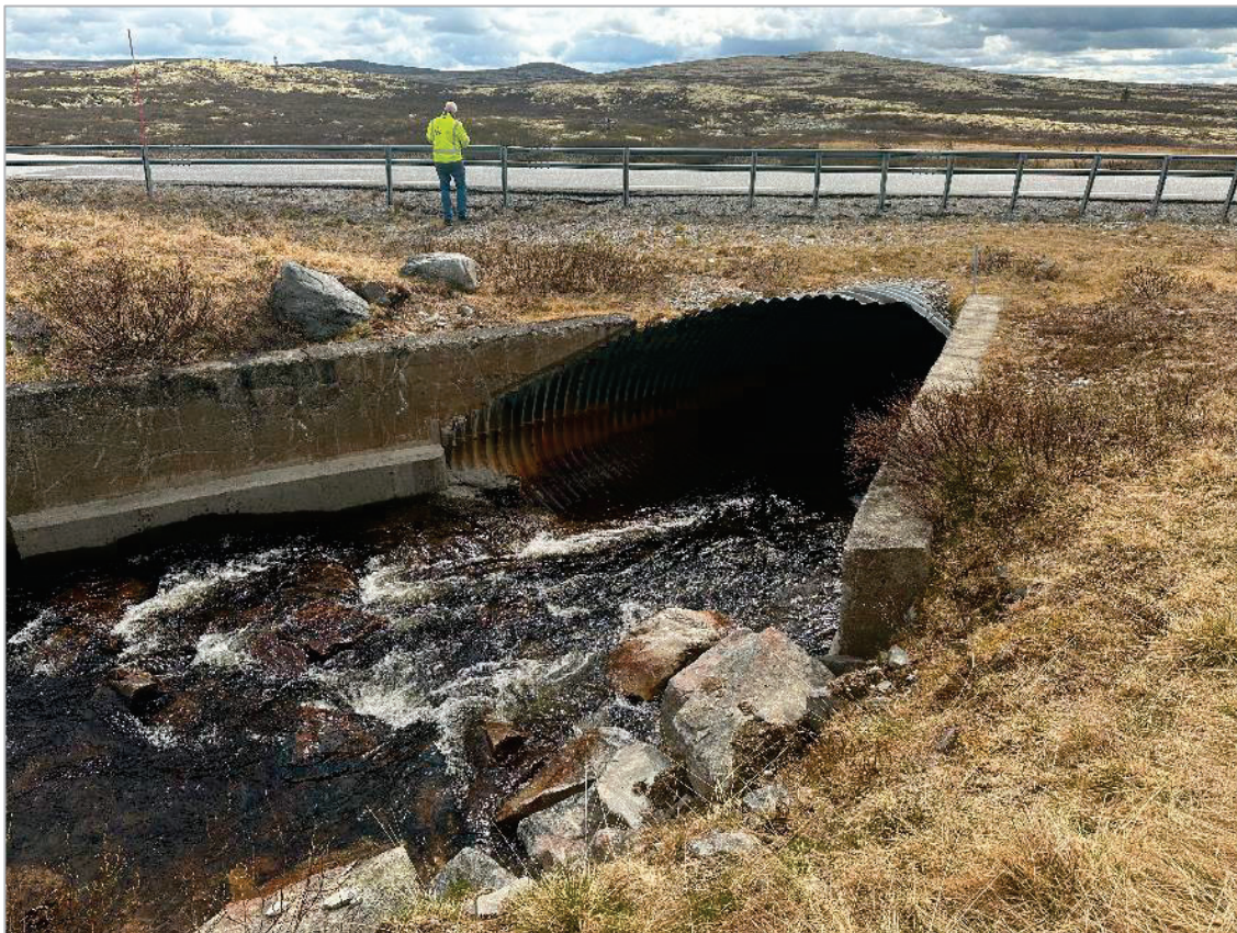
Figur 8: Eksisterende stikrenne, Oppstrøm
