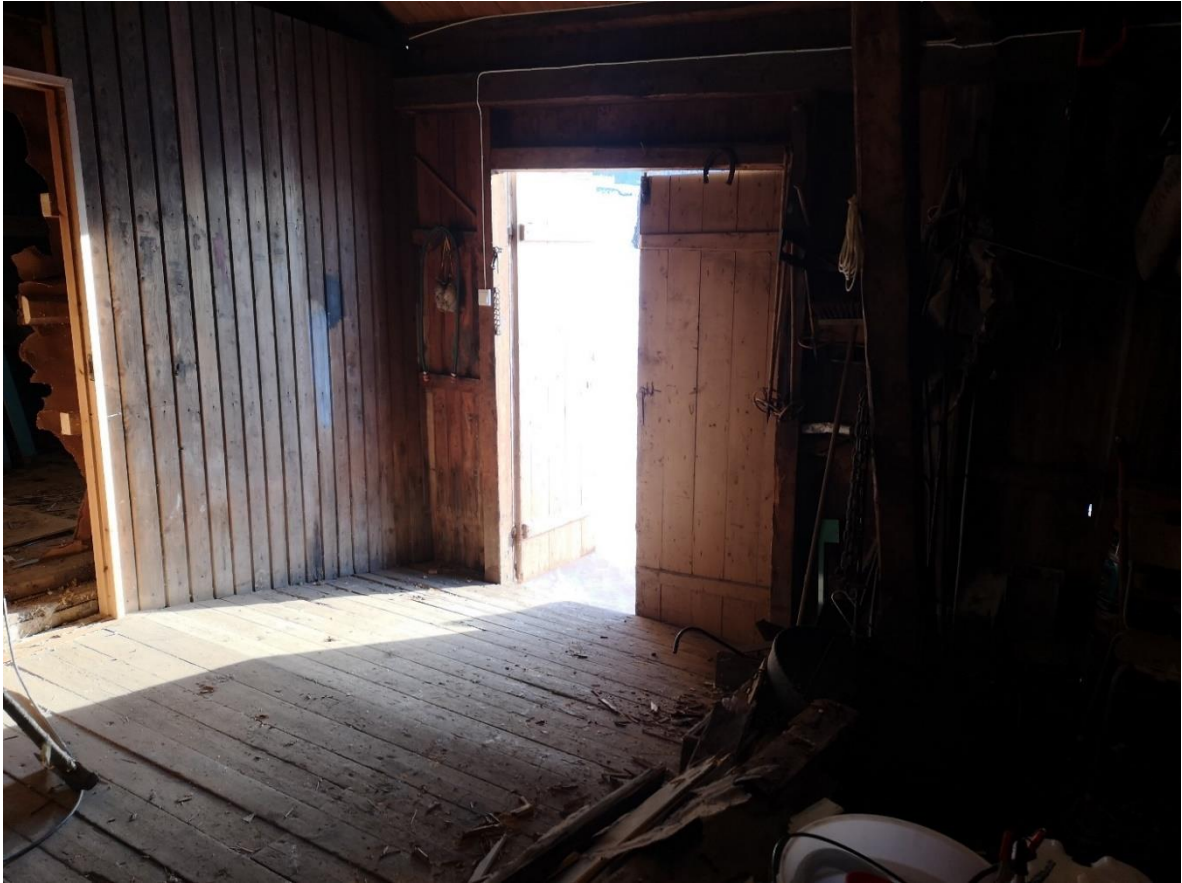
Porter inn til lagerrom fører inn til ei stigende rampe før overgang til golv
