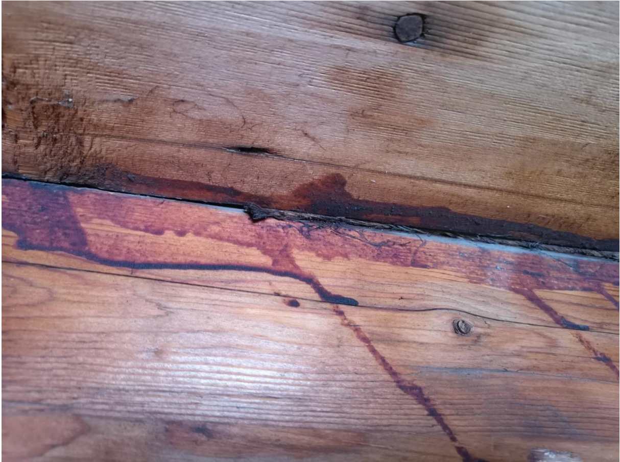
Tetting (nating) med hamp eller lignende, kombinert med det som antas å være tjære er benyttet til tetting mellom sperre og himling i loftsetasjen
