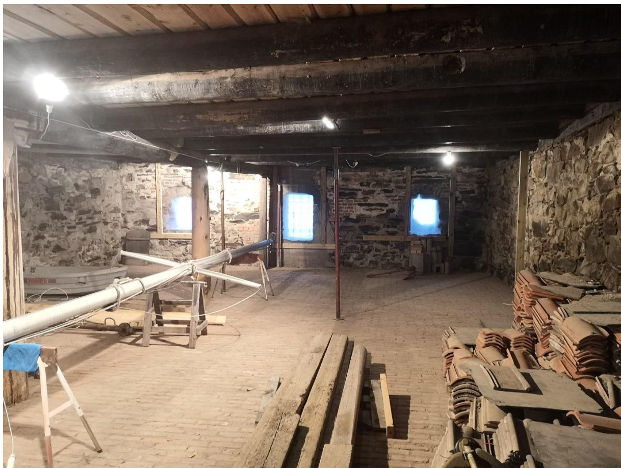
Nedre lagerrom. I gulvet er teglstein lagt tilbake der den lå før rehabilitering. Murverket kan leses i veggene. Taksteinen lengst til høyre i bilde er ubrukt, og kan være fra et av de siste varepartiene som ble lagret i Thorstadbua før den ble tatt ut av bruk. Midtre åpning i gavlvegg er redusert. Den har tidligere gått ned til golvet.
