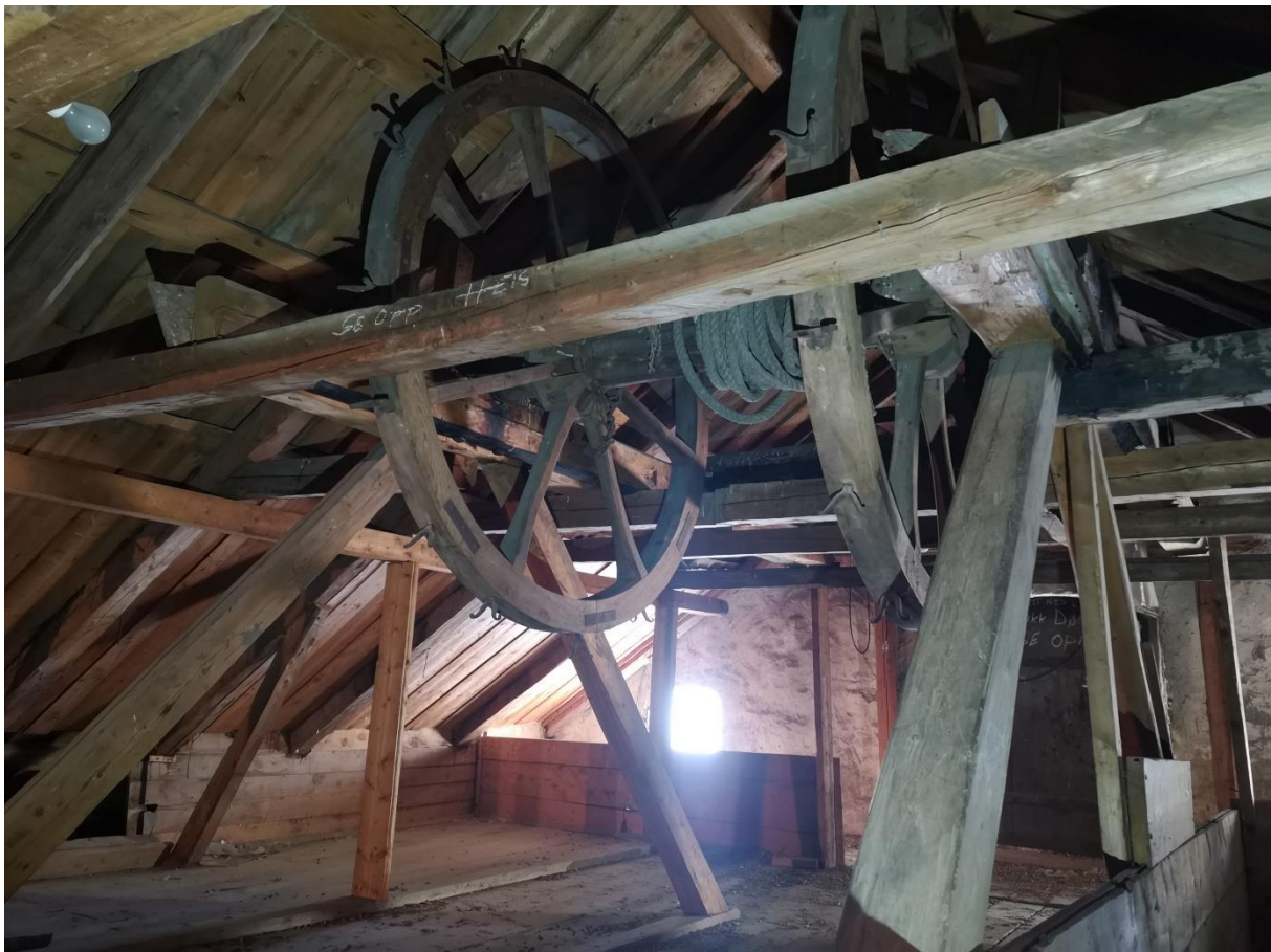
Vinna på loftet er intakt, men tau til å betjene den fra etasjene under mangler
