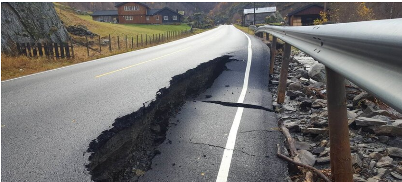
Flaumskader på fylkesveg 55, Lom kommune.
